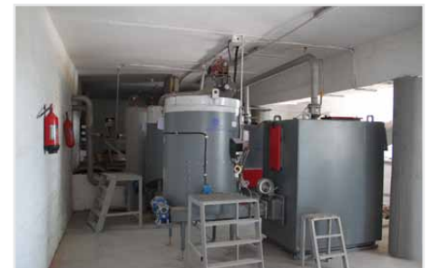
Котельня для обогрева помещений
